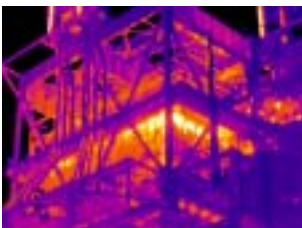
図 1-1 発電所ボイラー壁： 断熱不良
